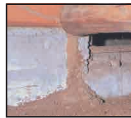
●地面から根太に伸びる「蟻道」
