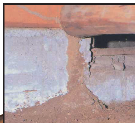
●地面から根太に伸びる「蟻道」
