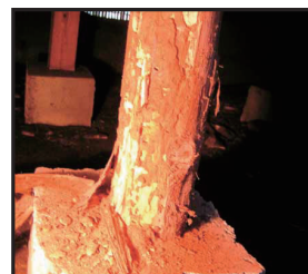
●白アリの被害を受けた束柱
